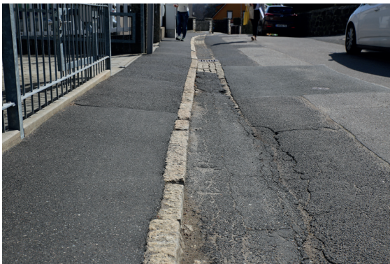
Abbildung 32: Beispiel für Straßenschäden
